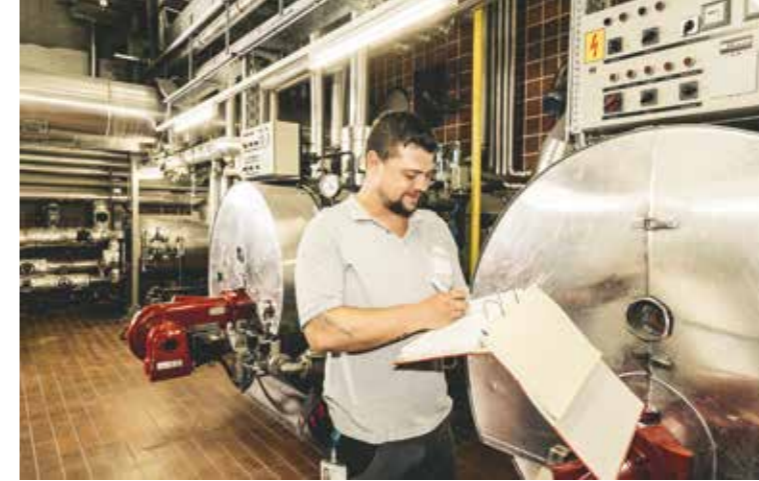
Christian Schmollengruber überprüft die Dampfkessel, die unter anderem die Küche, die AEMP und die Klimaanlage mit Dampf versorgen.
