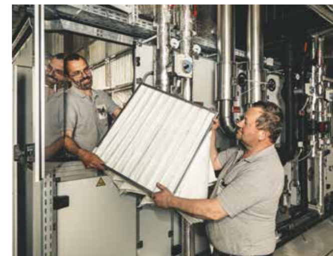
Hubert und Günter Braun bei der Wartung der Lüftung für die neuen Operationssäle
